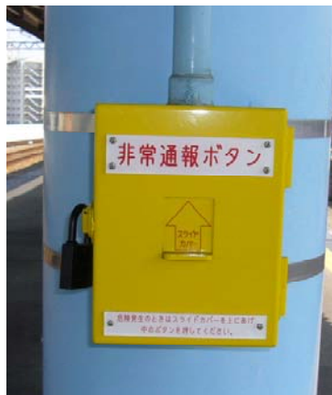
【非常通報ボタン】
