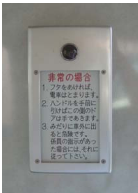
【非常通報装置】
