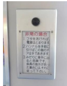
非常通報装置
