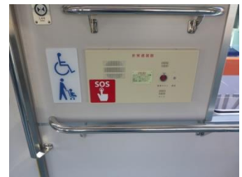
非常通話装置
