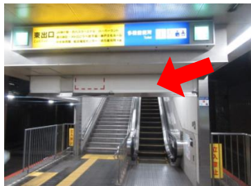
防火防煙シャッター
