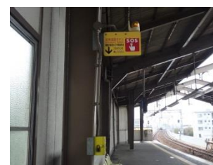
非常通報ボタン
