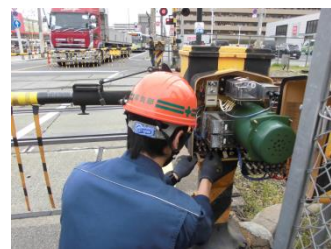
踏切保安装置の定期検査
