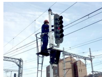
信号機の定期検査
