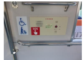
非常通話装置
