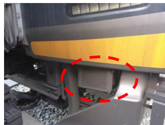
転落防止放送装置
