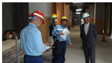
現場巡視(大石変電所新設)
